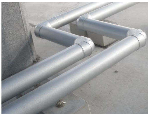
写真:給水管(露出:ラッキング処理)
